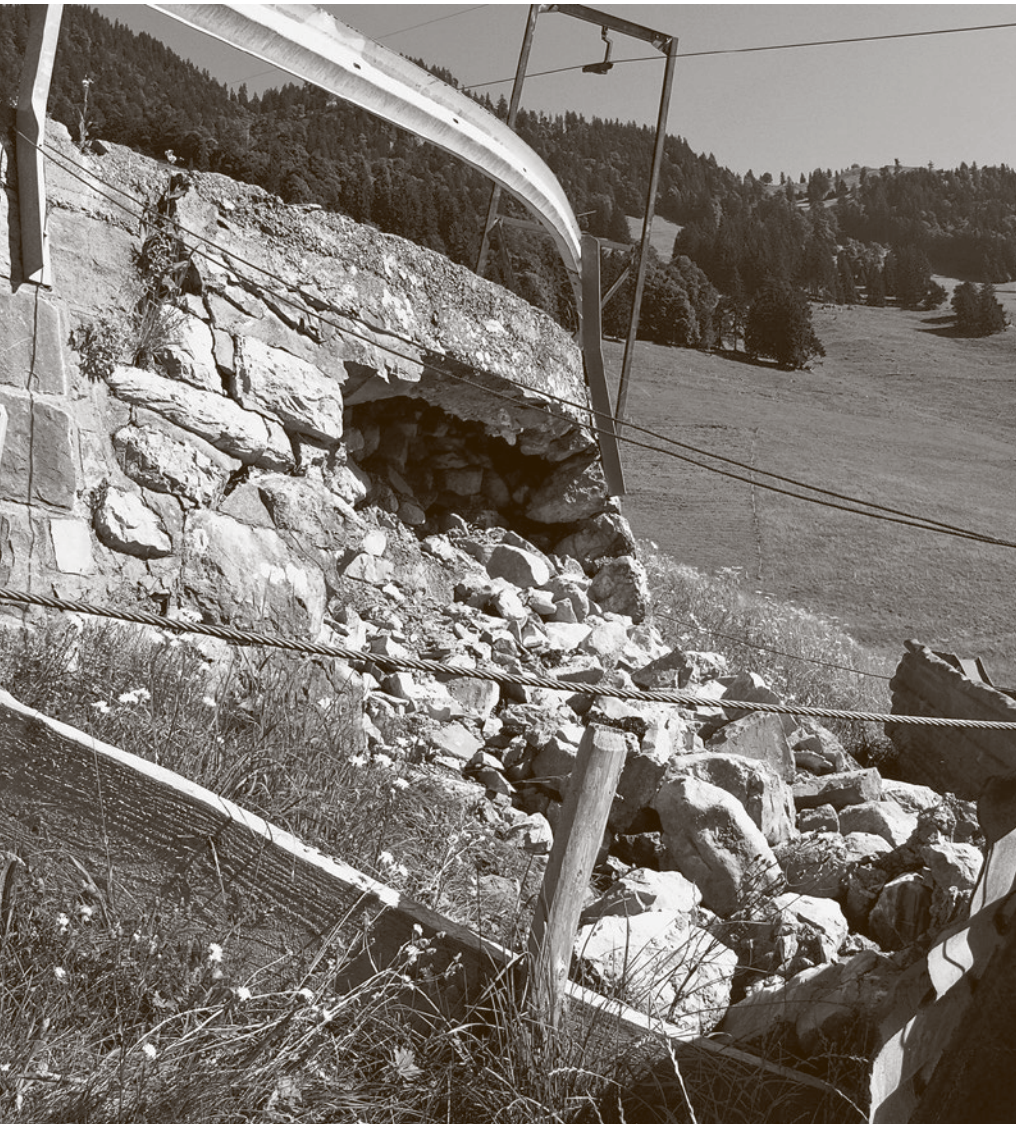
Ausbruch der Stützmauer beim Gislerrank
