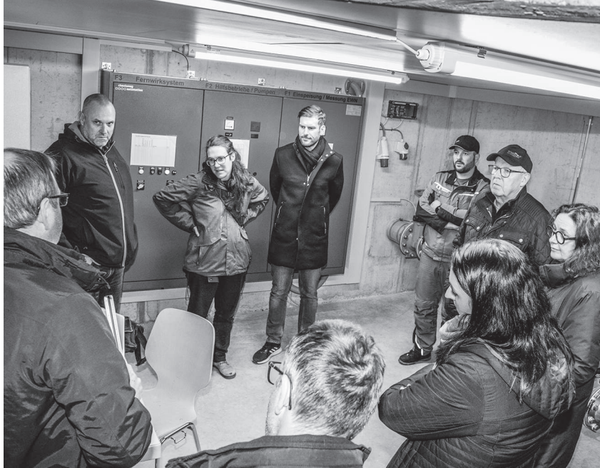
Lucas Wagner von der Centraplan erklärt den Vertreterinnen und Vertretern der Gemeinde Stans, der Gemeinde Dallenwil und der Uertekorporation im Verbundschacht, was in diesem Schacht alles enthalten ist
